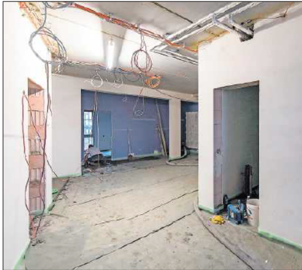
Hier geht es rein: Vom Eingang aus gelangt man direkt in den Warteraum. Der Gang links führt ins Einwohnermeldeamt.
